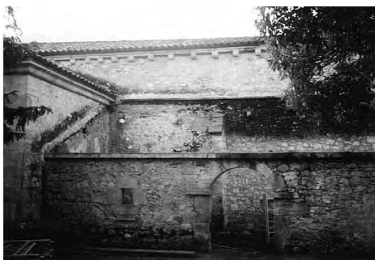
A.- Situación anterior; Osario y acceso Norte al Pórtico Foto: Pedro Fernández Gonzalo
